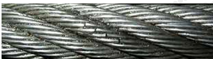
Rottura dei fili
