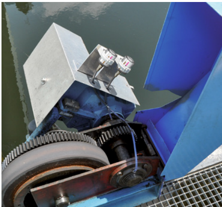
Lubrificazione dei cuscinetti tramite tubi flessibili in una vasca di sedimentazione secondaria.
