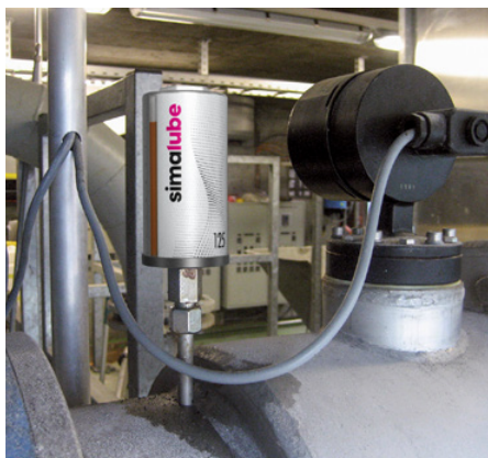
Lubrificazione dei cuscinetti: il lubrificante viene erogato sul cuscinetto attraverso una breve prolunga.
