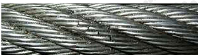
Rotura de hilos
